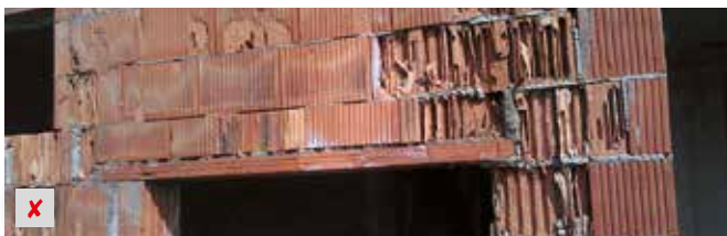
Oštećeni zid od cigle
